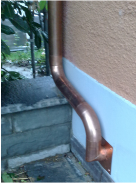
DC-Leitungen in Schutzrohr RF2 und in Cu-Fallrohr RF1 an Aussenfassade
