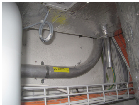
DC-Leitung in komplett geschlossener Alu-Rohrleitung
