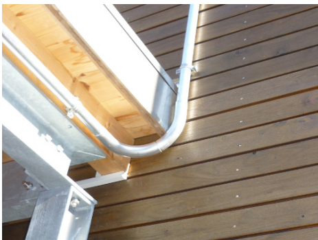
DC-Leitung auf brennbarer Holzfassade in nichtbrennbarem Schutzrohr RF1
